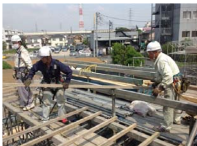
協力会社の職長OBを講師として招き、技術の伝承をはかっている。写真はとびコースの足場組立の実習状況
